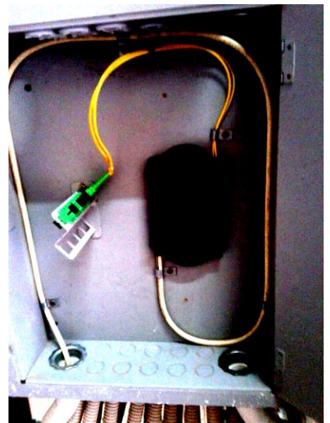
Caja Óptica Distribuidora de piso.
