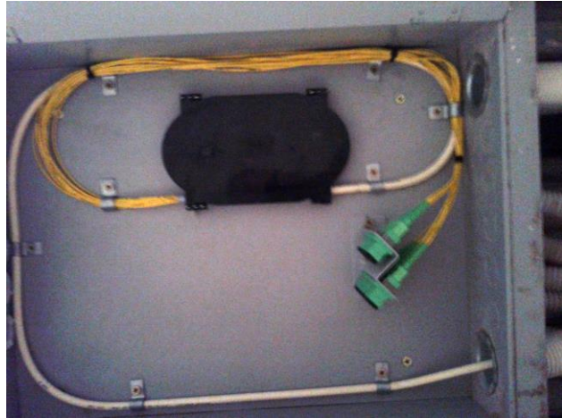
Caja Óptica Distribuidora de piso
